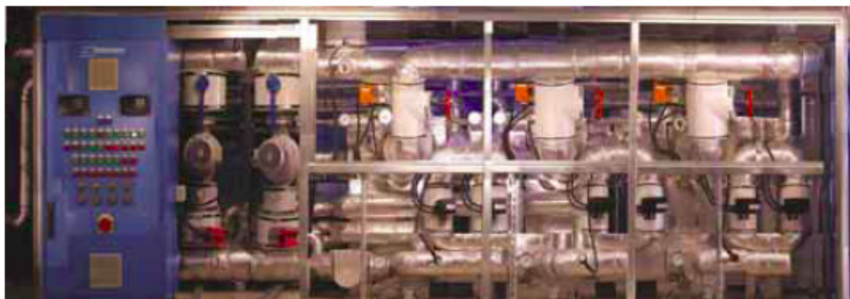
Anschlussstation (Bild z. Vg.g. Steinemann AG)
